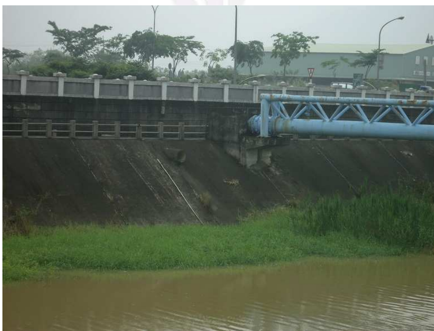
(圖二十一 北清水溝溪堤防的一排水孔)
