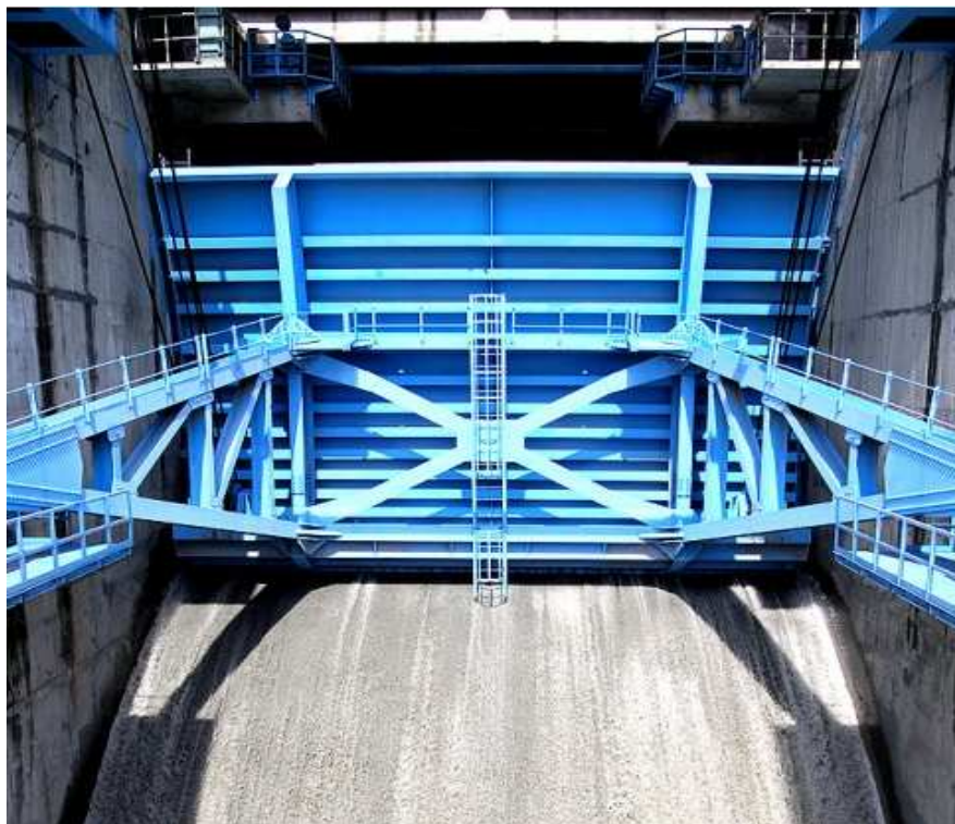
(圖十四 集集攔河堰之弧形閘門)
