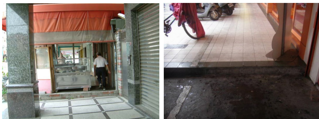
▲騎樓落差太大造成行走障礙
